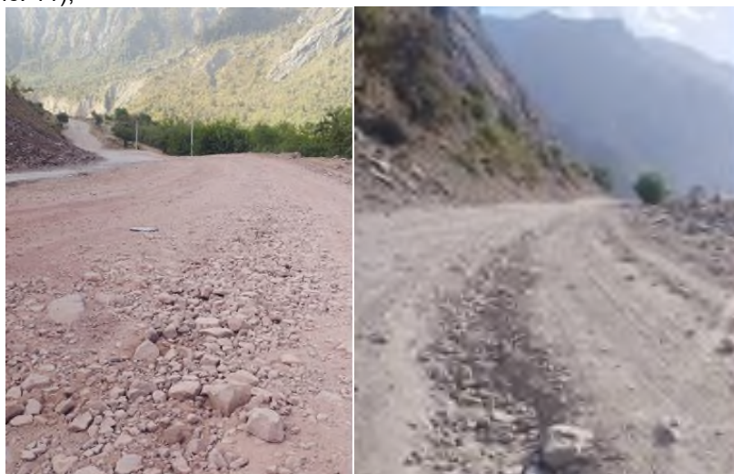
Рисунок 11 – Состояние поверхности дорожного полотна
